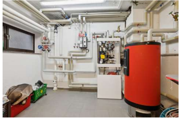
Heizungs u Waschmaschinenraum
